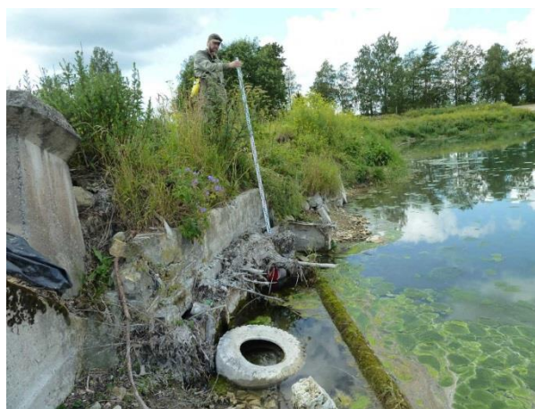
Рис.3.14. Река Хревица, п. Каложицы. Насыпная плотина, русло реки захламлено бытовым мусором, автодорога без покрытия
